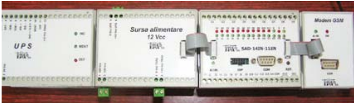
Sursa de alimentare neîntreruptibilă Sursa de alimentare stabilizată 220 Vca / 12 Vcc Echipament de achiziție date SAD-14IN-11EN Modem GSM
